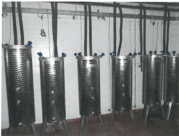
Particolare dell'interno, tini in acciaio con circuito refrigerante
