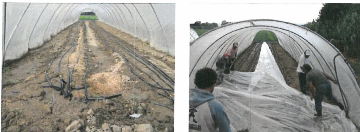
Fig. 9 - 10 – Eliminazione del vecchio film e sostituzione con la pacciamatura in PE trasparente
